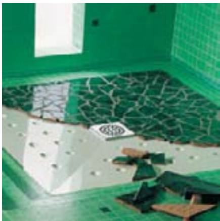
Réalisation d'une douche de plain-pied avec un receveur à carreler Fabricant Wirquin Plastiques
